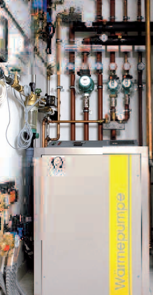
Eine Wärmepumpe sorgt für wohlige, umweltfreundliche Wärme Foto: Krügl
